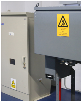
DSS A Yorkshire Switchgear Ringmaster SF 6
